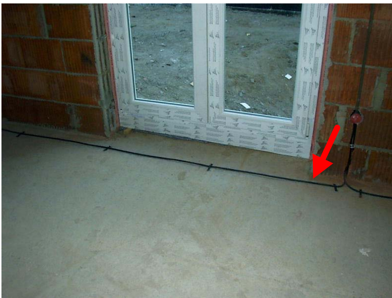
Bild 10 Fehlende unter Abdichtung
