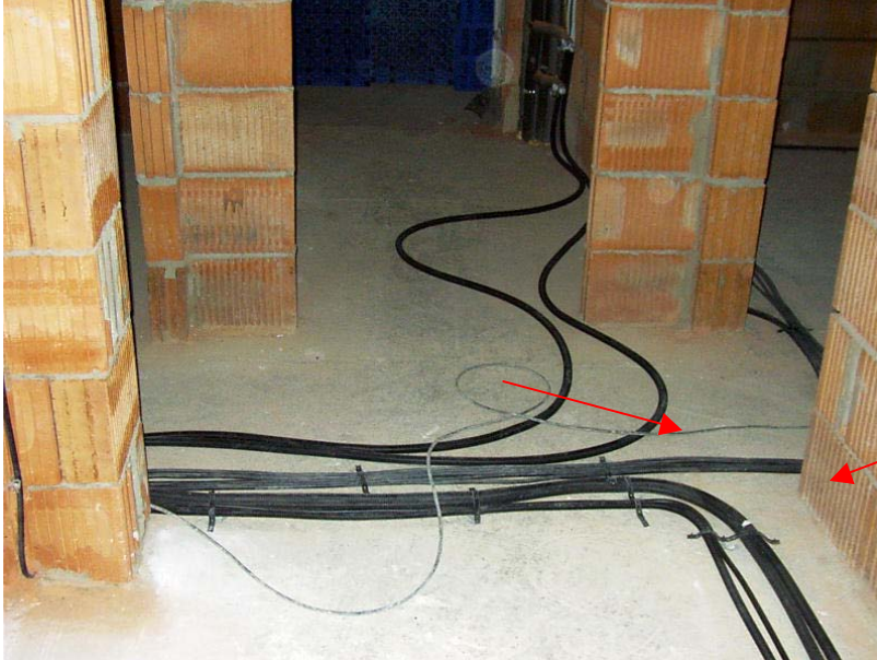
Bild 3 Leitungen sich nicht am Boden befestigt
