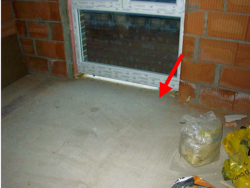
Bild 11 Fehlende unter Abdichtung
