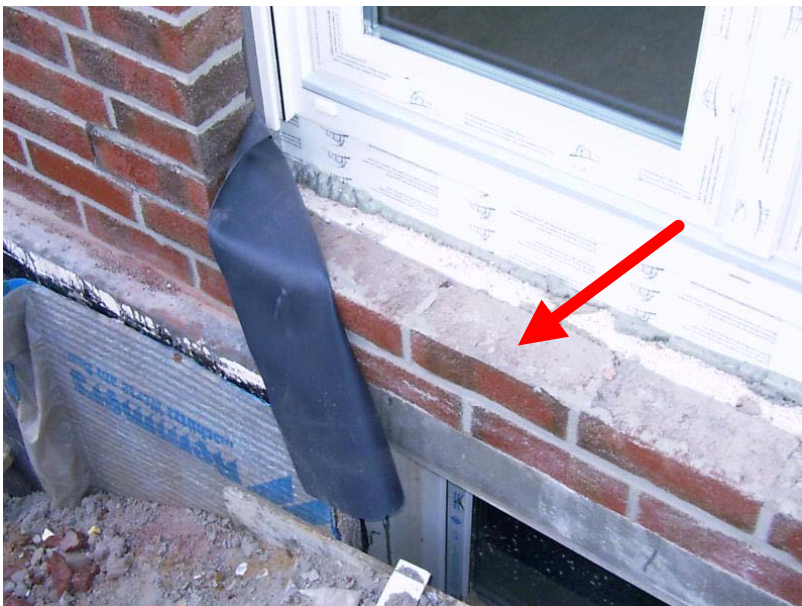
Bild 6 Äußere Fensterabdichtung fehlt noch
