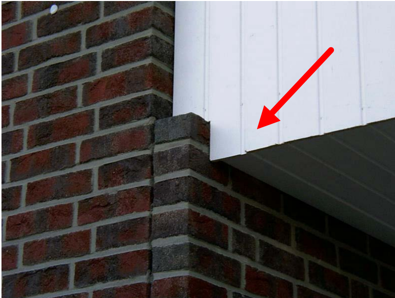
Bild 7 Holzverschalung steht zurück
