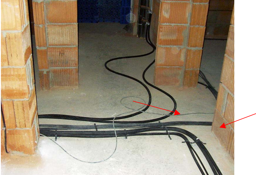
Bild 3 Leitungen sich nicht am Boden befestigt
