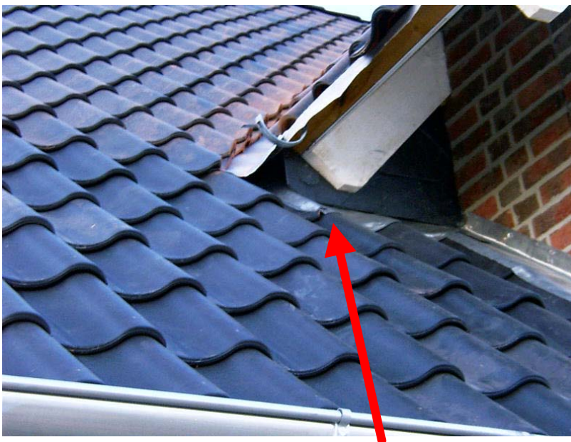
Bild 8 Hohlraum/Loch unter dem Kehlblech
