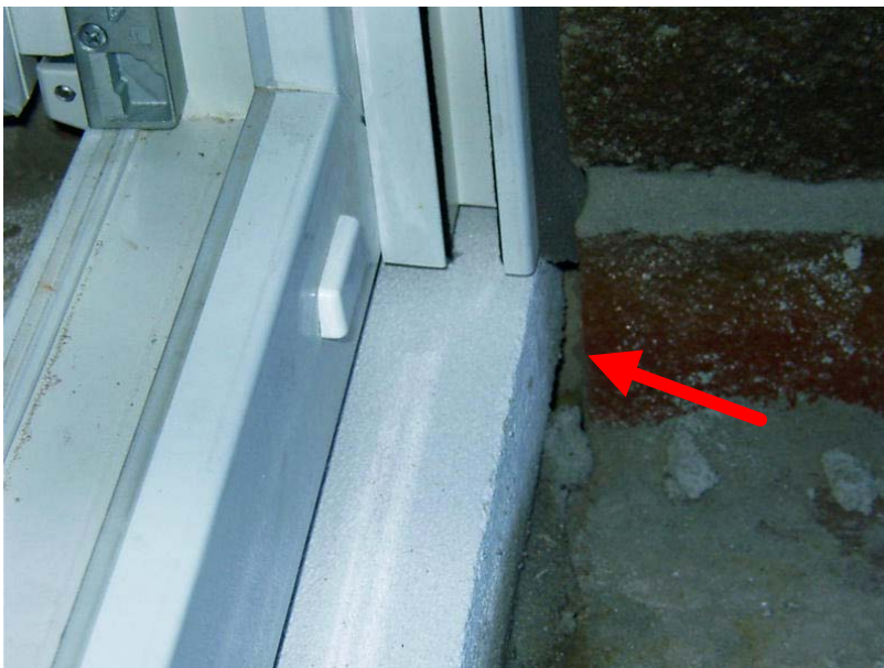
Bild 12 Porenbetonstein sitzt zu nah am Fensterrahmen
